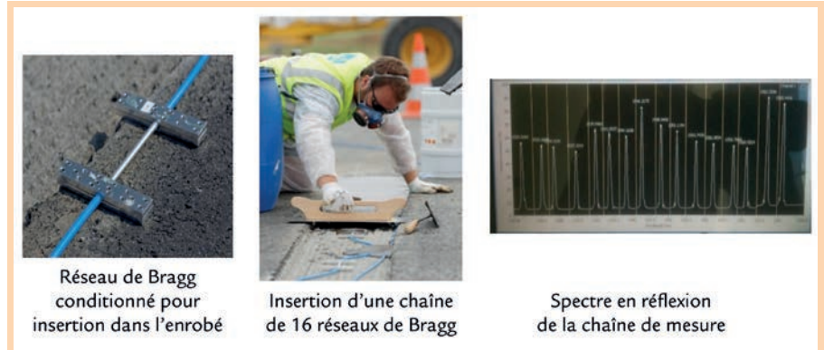
Figure 6. Conditionnement spécifique de réseau de Bragg pour insertion dans l'enrobé de tarmac.
