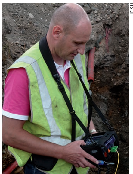
Photo 2. En action sur le terrain, un mini-OTDR dans sa sacoche d'utilisation « mains libres ».
